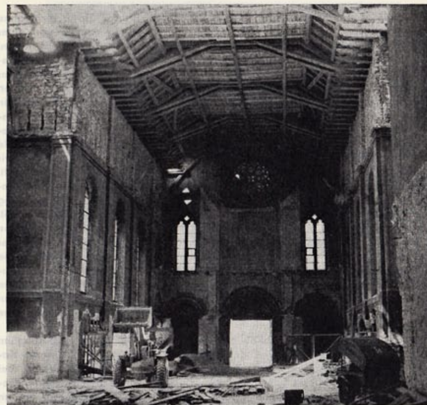
Das Innere der Kirche wurde zur Baustelle, das Gewölbe und die Empore sind abgebrochen
